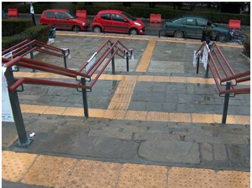
Εξοπλισμός και σήμανση σε κλιμακοστάσιο
